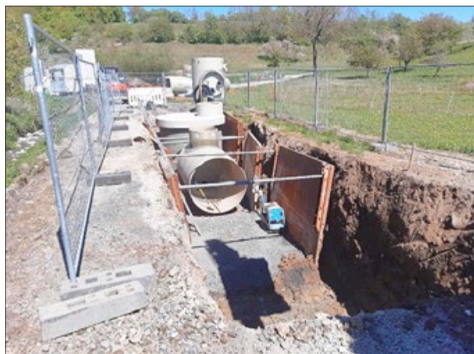
Ein Stauraumkanal wurde der Kläranlage vorgeschaltet und speichert den ersten Schmutzstoß.
