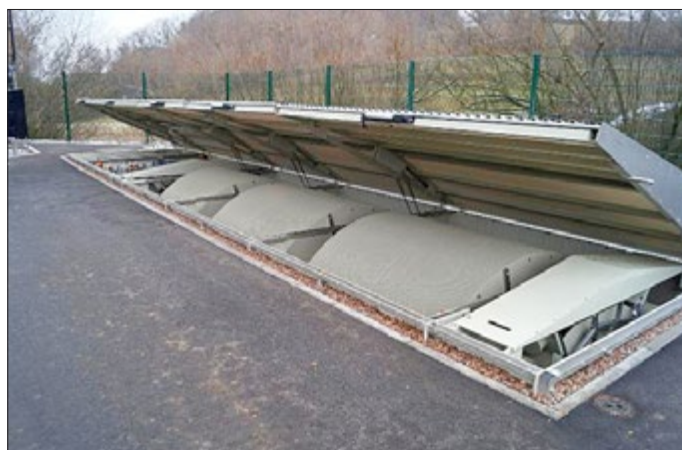
An den drehenden Scheibentauchkörpern wird sich der biologische Rasen aus Klärschlamm bilden.
