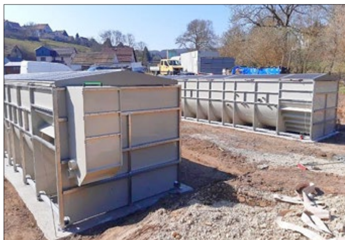
In der zweistraßigen Scheibentauchkörperanlage wird das Abwasser gereinigt.
